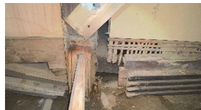
(b) 耐震補強個所の損傷
