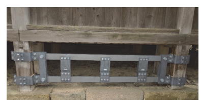
実際の設置状況
