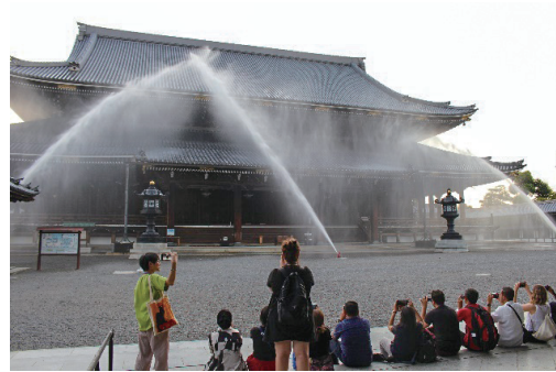
東本願寺における防火設備の 放水デモンストレーション
