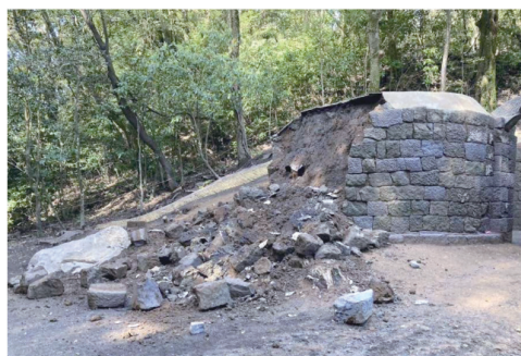
写真2 再崩壊した石積み擁壁：鹿児島市教育委員会提供
