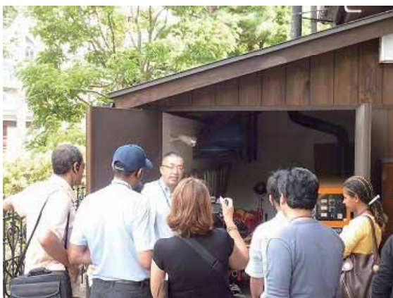
防災設備の説明を受ける研修員（高山にて）
