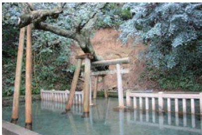
土砂がむき出しになった斜面
