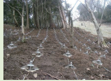
写真-19 頭部ワイヤー連結型鉄筋挿入工 施工斜面の状況(施工直後)
