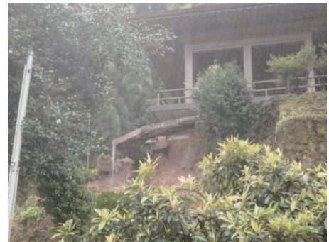
写真-6 覆堂基礎部の崩壊状況
