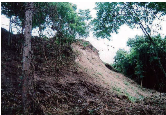
写真-7 崩壊した城内の土塁
