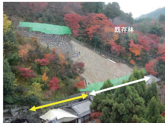
写真-4 2014年の斜面状況
