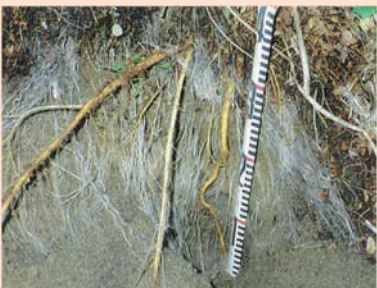
写真-7 補強土内への根の伸長状況
