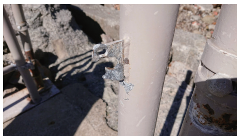
写真 12 台風による被害の様子
