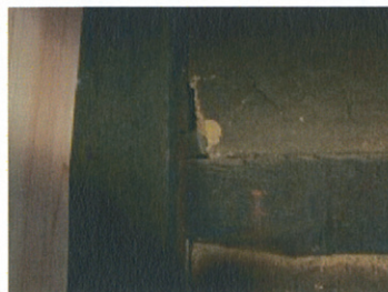
(d) 土壁の割れ
