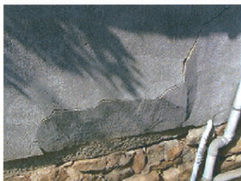
(c) 外壁のひび割れ
