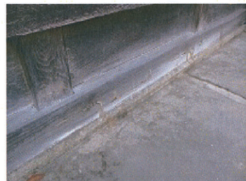
(a) 土台の蟻道
