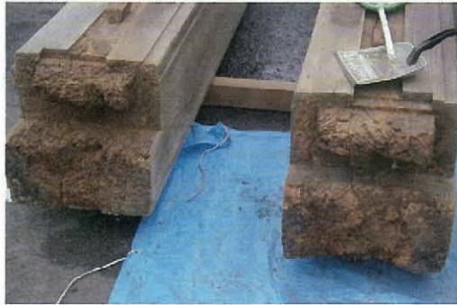
(a) 本柱根元の腐朽
