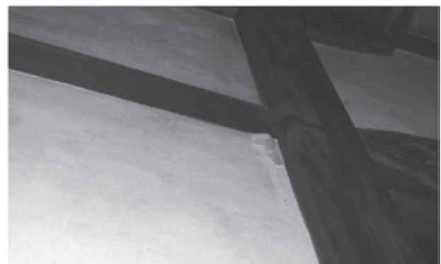
図11 内陣北面東端小壁 亀裂が生じている。
