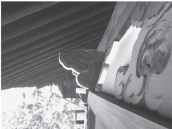
図6 台輪・絵様肘木・軒桁 内側に大きく転んでいる
