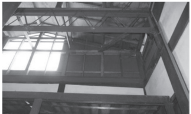
図9 後堂見上げ 小屋梁が鉄骨製トラスに取り替えられている。
