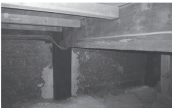
図2 床下の状況 コンクリート基礎が設置され、足固貫には腐朽がみられる。
