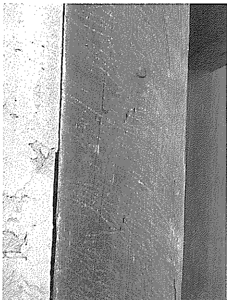
写真3 アライグマが頻りに上り下りした柱。複数の爪痕が残る。柱の上に侵入口があった。2009年12月撮影。奈良市法隆寺夢殿を囲む塀の南門。
