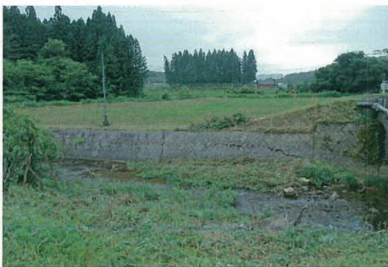
写真7 柵木立南方の地震断層と河床壁面の亀裂 (北東を望む)
