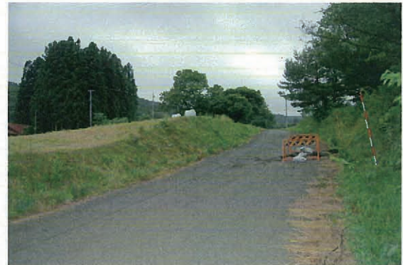
写真4 一関市岡山の低断層崖と道路面の地変
